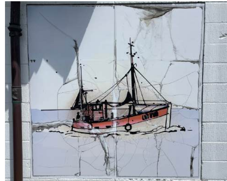
Stor plakat på fiskehandlerens facade, som en identitetsskabende kvalitet. Desværre i dårlig stand og kvalitet og vurderes ikke til at kunne udbedres.
