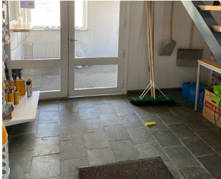
Indvendigt er indgangen fin og i rimelig stand.
