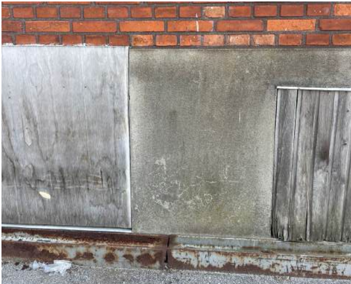
Høj betonsokkel der fremstår medtaget.
