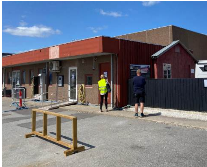
Facaderne er opført med søsten-betonelementer. Dog beklædt med rød malet træ på den ene gavl. Hallen uden åbninger med undtagelse af enkle porte og døre. Vinduer (røde) fremstår i dårlig stand. Saddeltag med lav hældning og beklædt med tagpap. Ovenlys i hal utæte som kan ses på synlige plamager.
