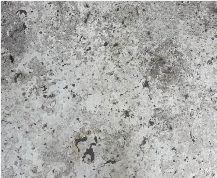
Betondæk i overordnet acceptabel stand med ujævnheder og lokale skader.
