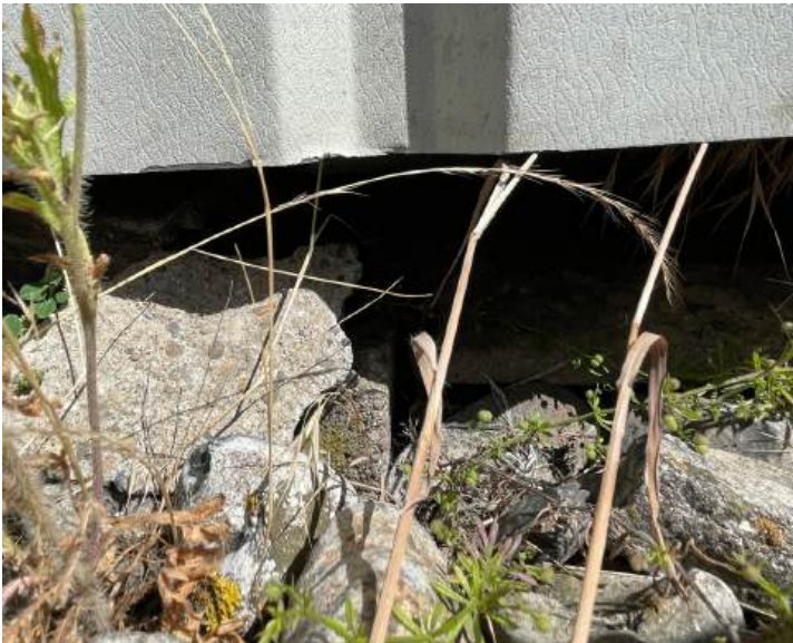
Lav betonsokkel i meget dårlig stand.
