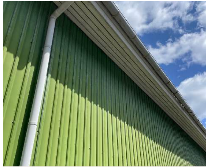
Facadeudsnit. Betonelementer med søsten. Synlige skader.
