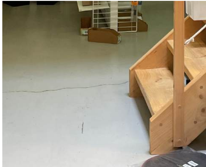
Terrændæk i beton med synlige skader.
