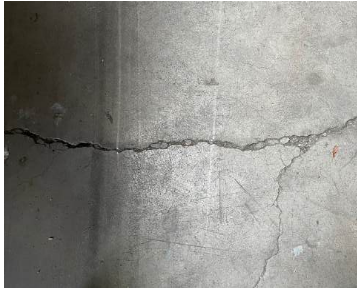
Terrændæk i beton. Det fremstår flere steder med store skader i overfladen og det mistænkes at det i nogle områder synker.
