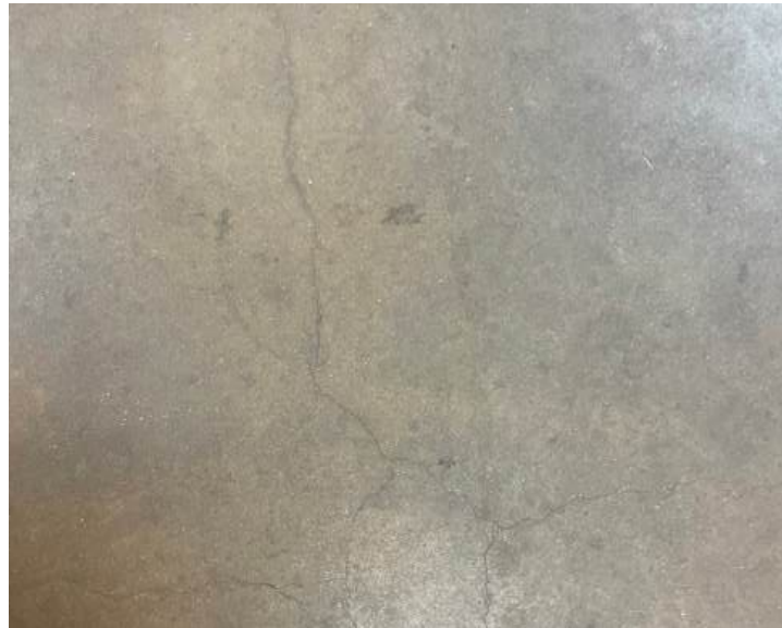
Betondæk i varierende stand.
