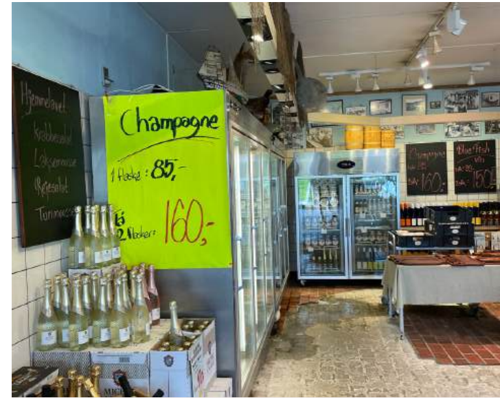
Butikslokale med flisegulv (dårlig stand) og pudset vægge delvis med fliser.
