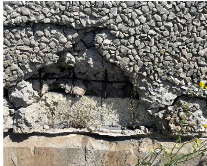
Synlige skader på facaden.
