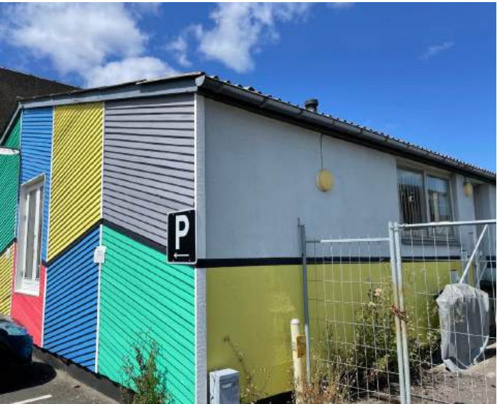
Ubehandlet letbeton sten. Facaderne er pudset og den ene gavl beklædt med malet træ. Saddeltag med bølgeeternit fremstår slidt, muligvis med asbest. Sternkant beton.
