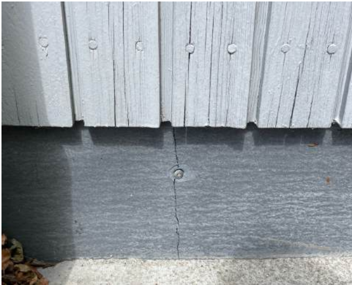
Formentlig letbeton men med fibercementplade skruet udenpå.
