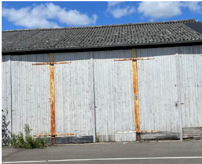
Gamle fine porte i hallens facade, men fremstår i dårlig stand.
