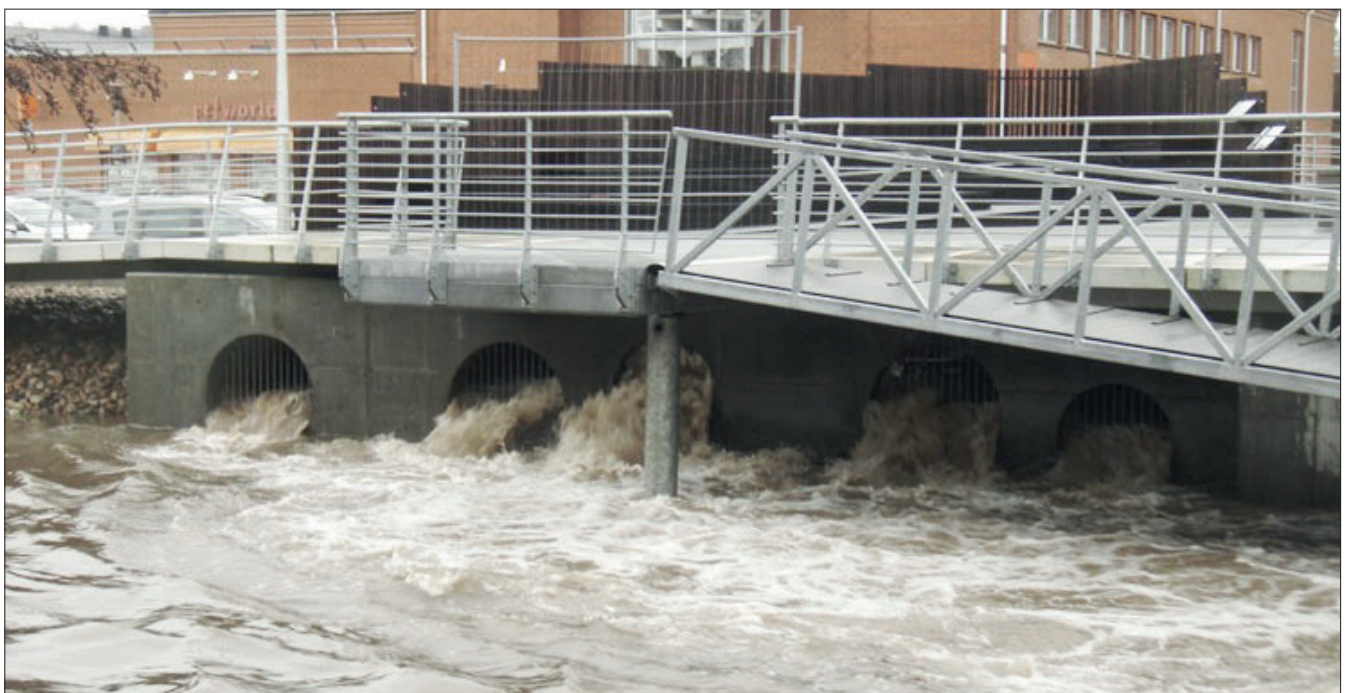
Sluse- og pumpebygværket i drift.
