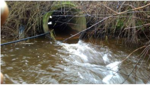
Station 3374 ø80 rørunderføring ved Mosegårdsvej Rørdiameter er for lille og ligger forkert
