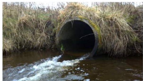
Station 3240 rørunderføring, ud. Rørdiameter er for lille.
