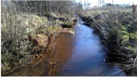
Styrt ved station 4570 set opstrøms
