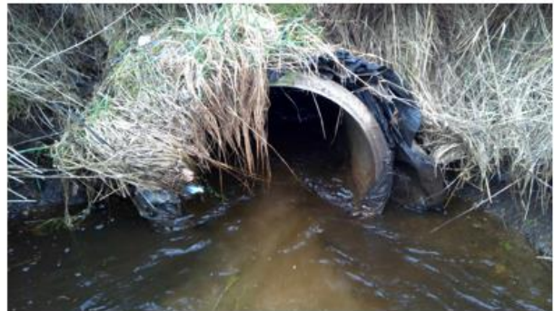
Station 3135 rørunderføring \varnothing 80 cm. Rørdiameter er for lille.
